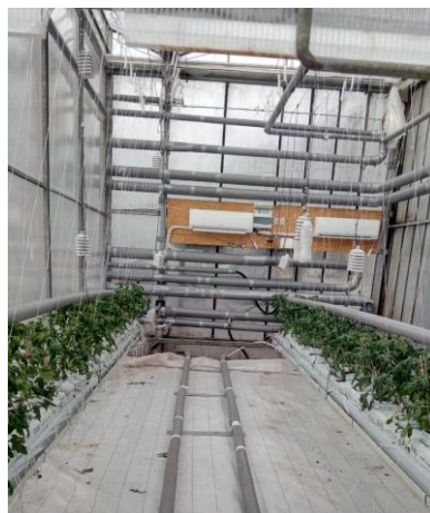
5.2. att. Siltuma sūkņa gaiss-gaiss un aprīkojuma izvietojums testa siltumnīcā.
