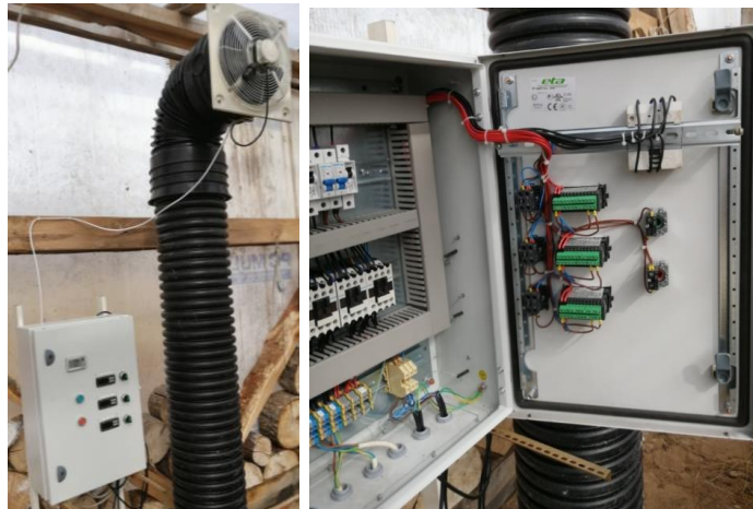
7.3.2.att. Automatizētas siltumnīcas ventilācijas (apsildes/dzesēšanas) sistēmas vadības bloks, eksperimentālajā siltumnīcā (50kvm) zs “Skudriņas”
