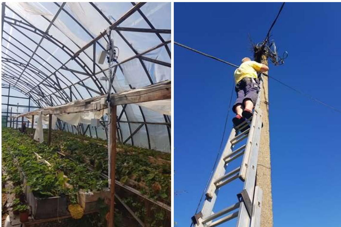
Attēls 3.10. Z/S Eži, IRIS jaudas sensoru uzstādīšana, elektrības un interneta kabeļa ierīkošana.
