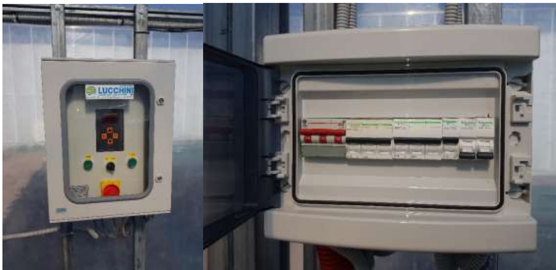
Attēls 3.2. Plēves siltumnīcas vadības kontrolleris un elektrubarošanas sadalne jaudas sensoru pievienošanai.
