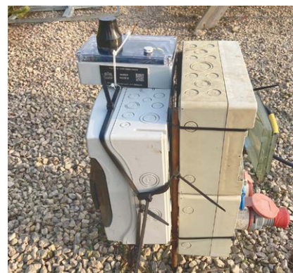
Vadības mezgli (mazā kaste augšā), kas nodrošina aeratoru attālinātu ieslēgšanu un izslēgšanu
